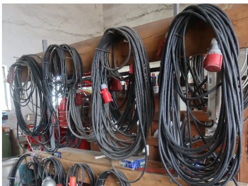
Elektrokabel müssen jährlich auf „ordnungsgemäßen Zustand“ geprüft werden.
